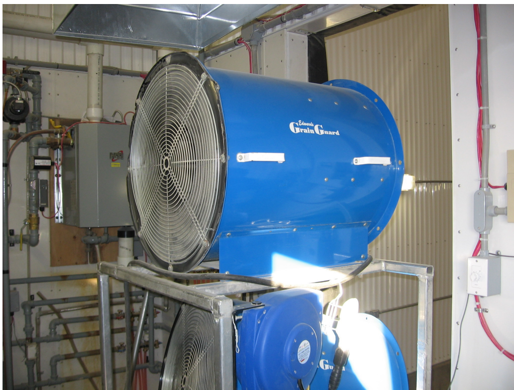
Figure A4.4 Deux ventilateurs dans chaque baie de séchage pousse l'air à l'intérieur du semi-remorque
