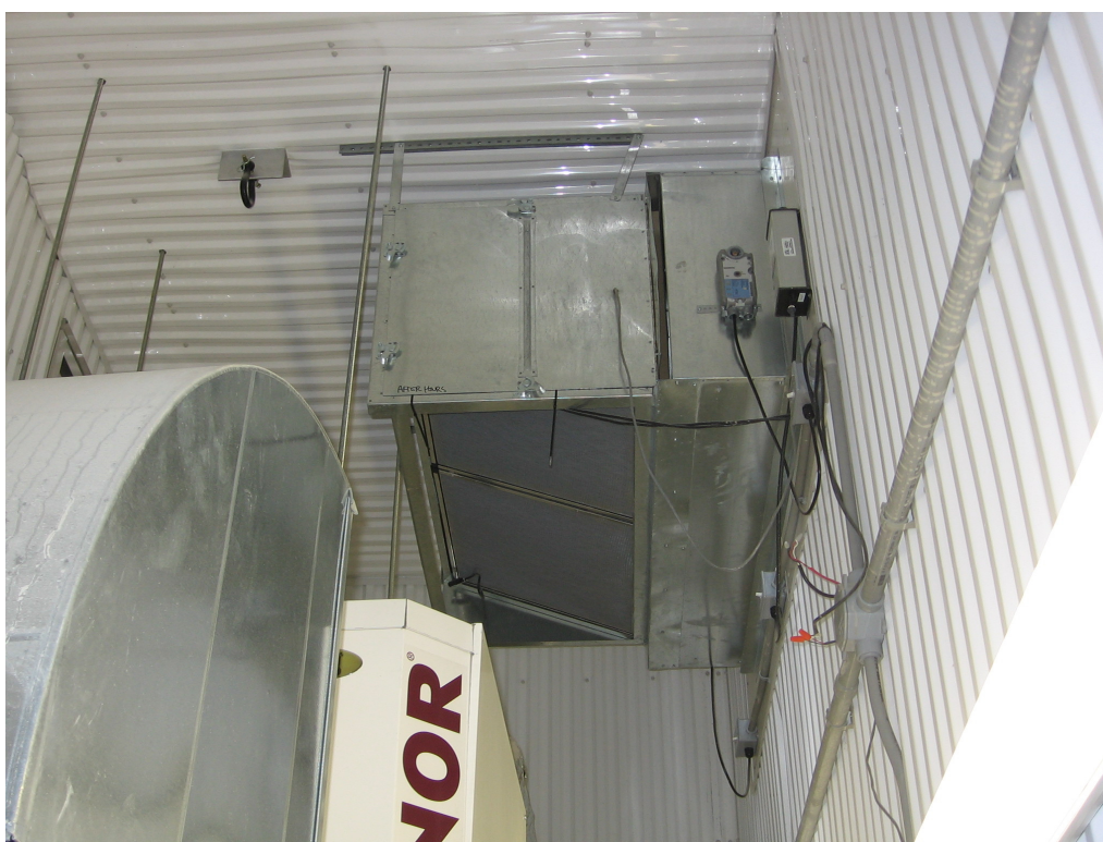
Figure A4.5 Un système de filtration et de traitement UV de l'air est installé pour une baie de séchage.
