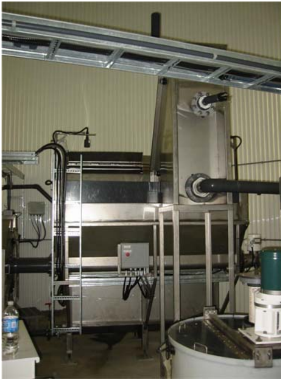
Figure 11 Vue générale d'un flottateur à air dissous (source : Horizon Environnement Technologies).
