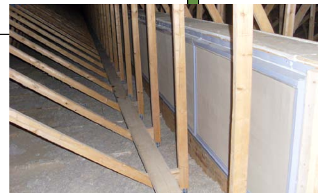
Figure 23 Filtre antimicrobien de première génération installé sur une entrée d'air linéaire continue
