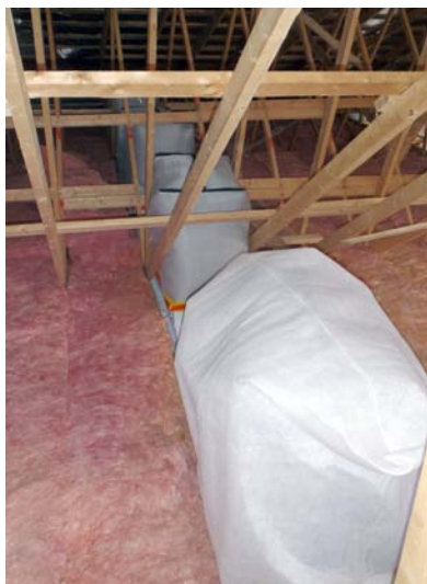
Figure 19 Filtre cubique et son préfiltre installés dans l'entretoit dont les fermes de toit sont espacées de 24 po.
