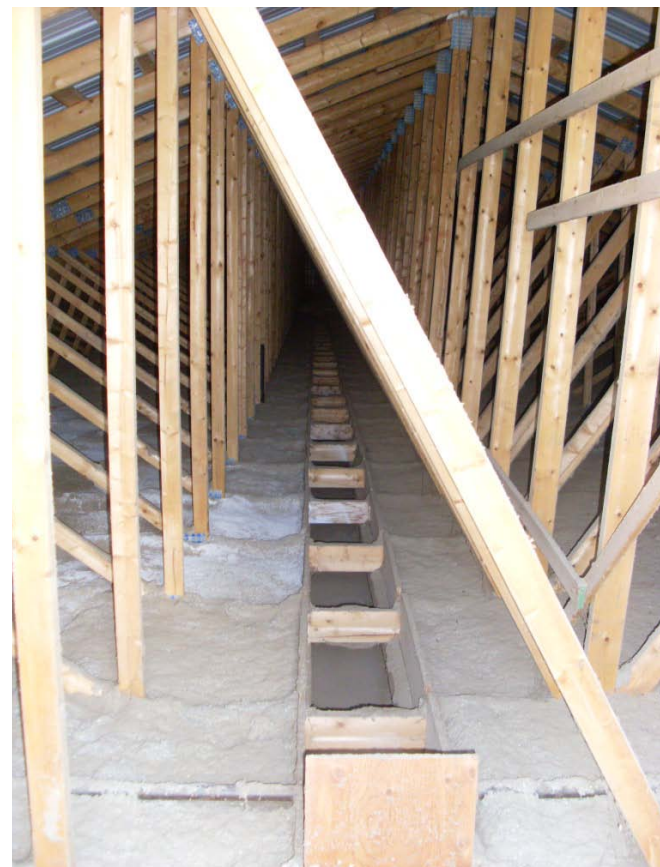
Figure 20 Entrée d'air linéaire continue sans filtre
