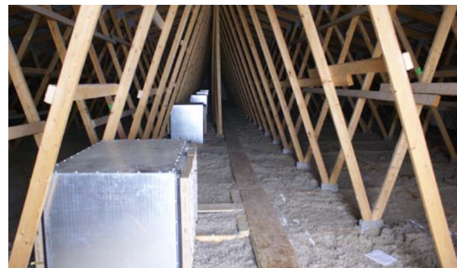
Figure 18 Filtres à caisson installés dans l'entretoit dont les fermes de toit sont espacées de 48 po.
